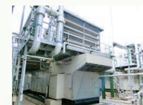
コージェネレーションシステム （電力と蒸気を効率的に供給）
