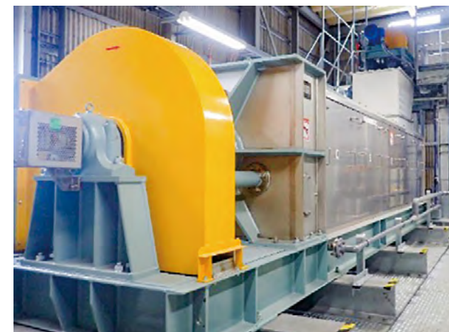
直江津工場に導入した脱水機
