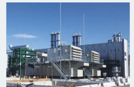
発電用ガスタービン増設により電力自給率を高める群馬事業所
