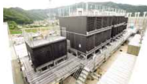
クーリングタワー設備
