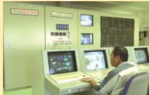
設備の運転状況を集中管理
