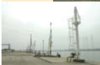
バースとその消火設備
