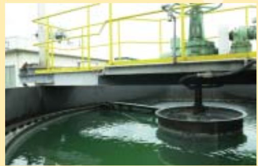
排水処理設備
