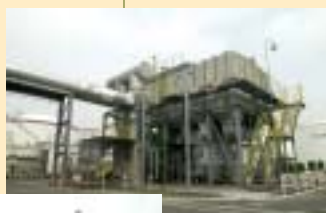
排ガス処理設備
