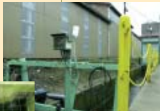
排水監視機器
