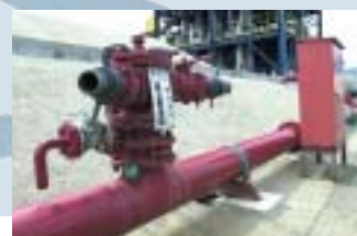
消防車用消火栓
